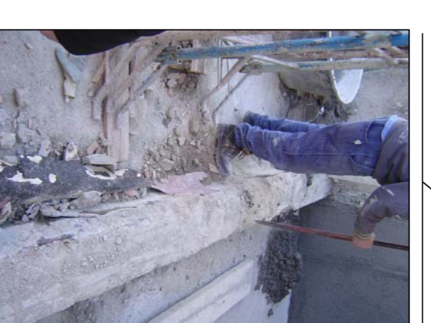
Rinvenimento trave estradossata
