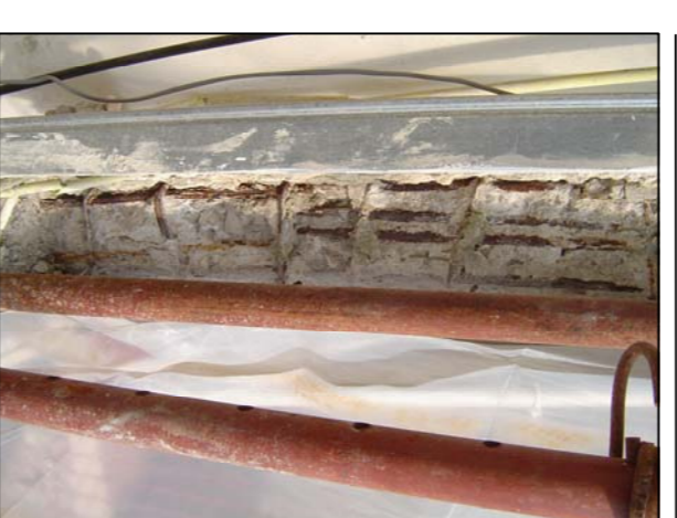
Piastro dove è presente una forte concentrazione di armature corrose senza adeguato copri ferro
