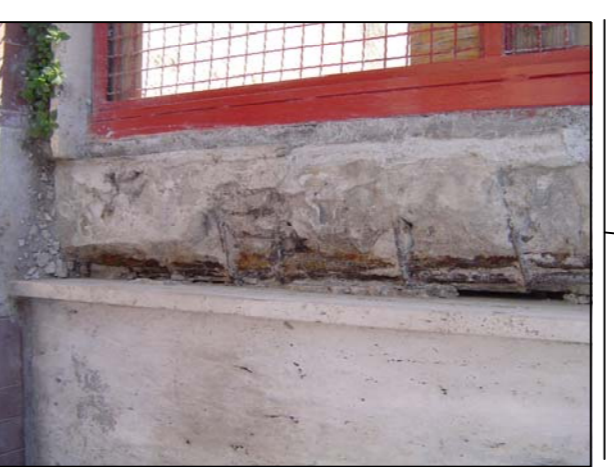
Piastro in avanzato stato di degrado
