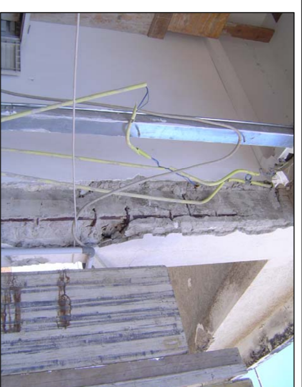
Presenza di calccestruzzo di scadenti caratteristiche
