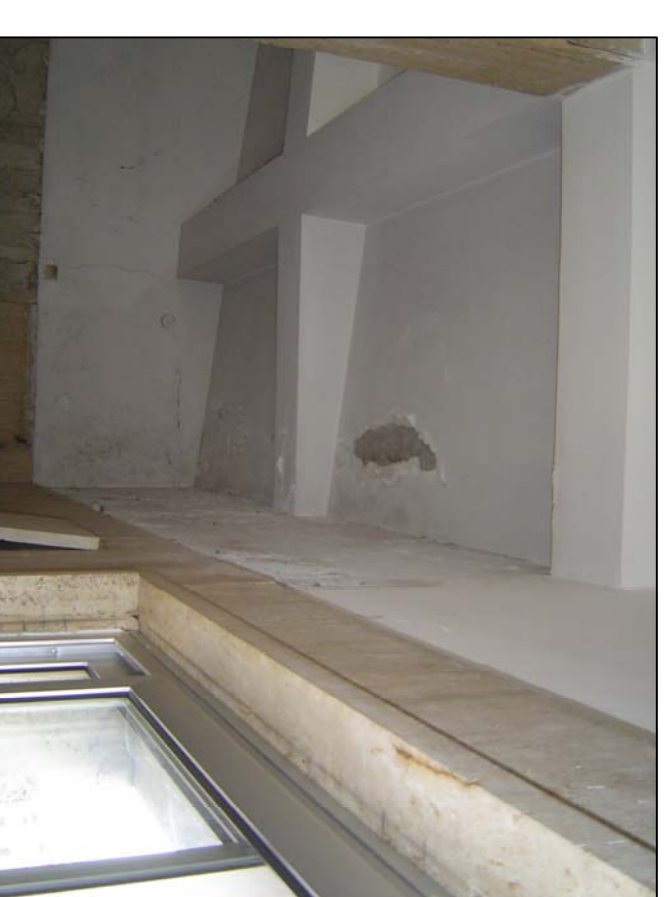
Presenza di infiltrazioni dal tetto
