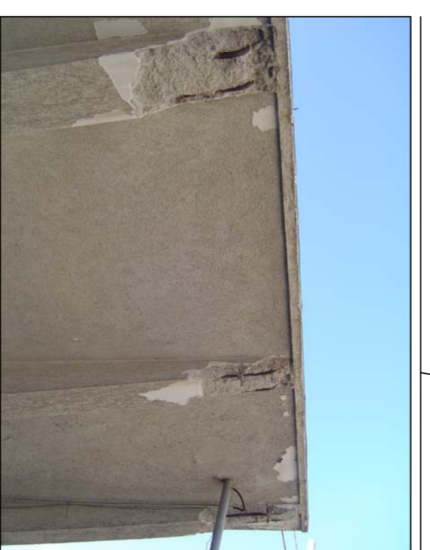
Visa pensilina con travi in avanzato stato di degrado
