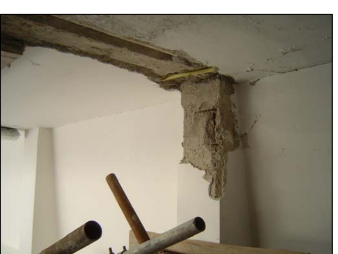
Travi con presenza di armature corrose
