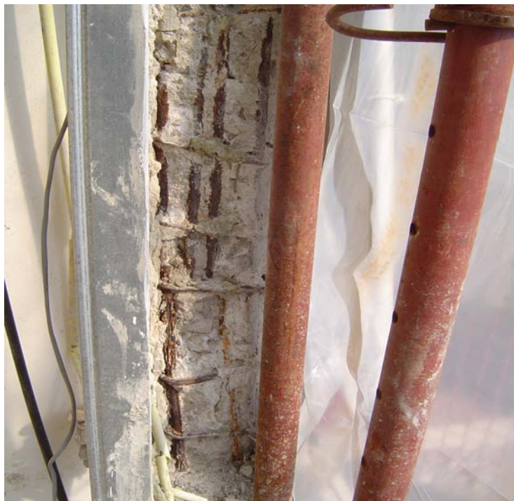
Pilastro d'angolo dove si evidenzia l'avanzato stato di corrosione delle armature principali e la mancanza di staffe idonee.
