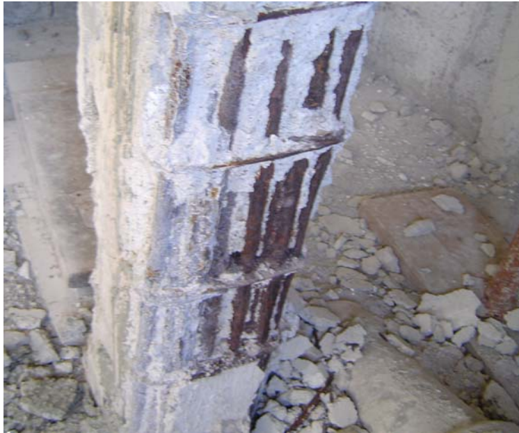
Pilastro seriamente danneggiato con armature in avanzato stato di degrado, calcestruzzo scadente e conseguente riduzione della sezione reagente.
