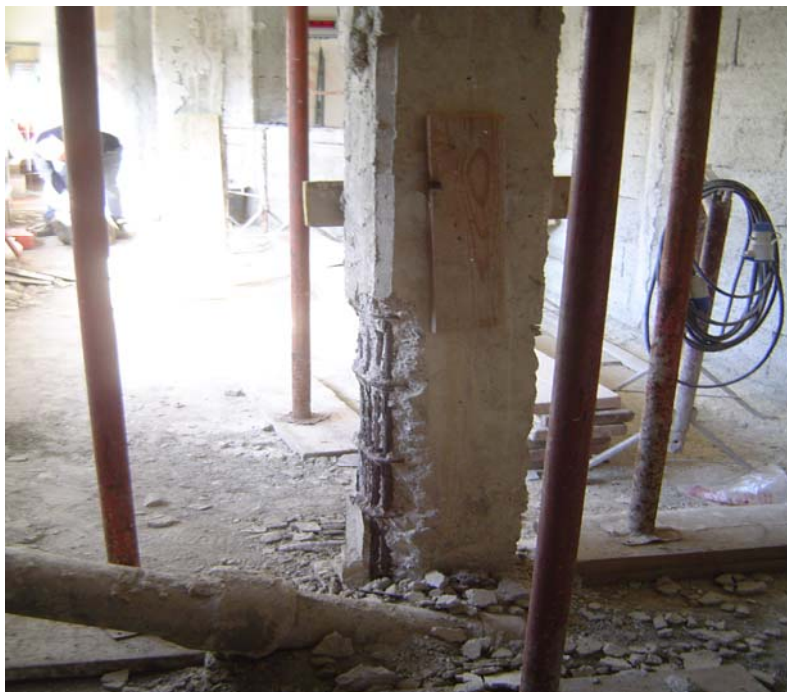
La presenza di armature corrose espelle il copri ferro riducendo drasticamente la sezione reagente come in questo caso.
