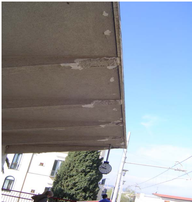
Vista pensilina con travi in avanzato stato di degrado
