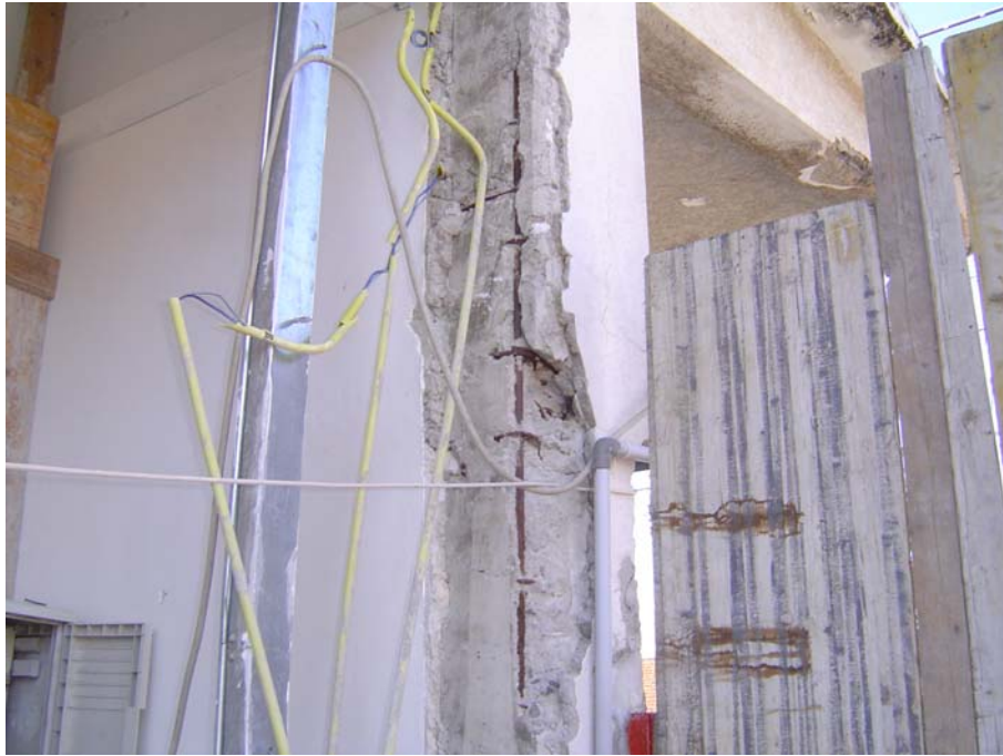
Presenza di calcestruzzo ed armature metalliche in cattivo stato
