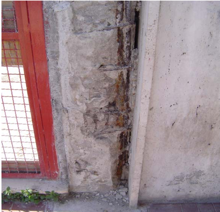
Pilastro dove è presente una forte concentrazione di armature fortemente corrose senza adeguato copri ferro.
